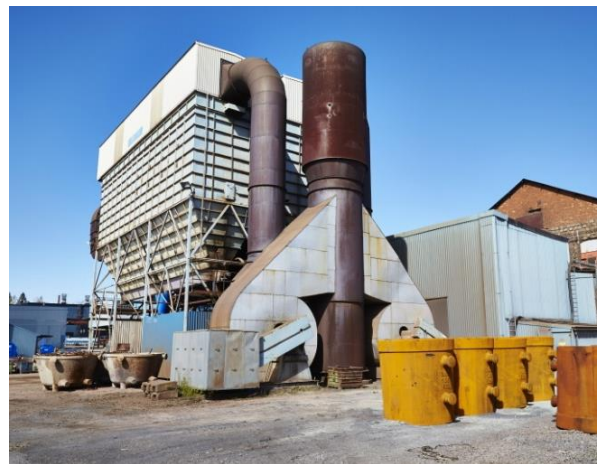
Rökgasfilter för omhändertagande av stoft vid Scana Steel Björneborg. Foto: Bildn, Jernkontorets bildbank.
