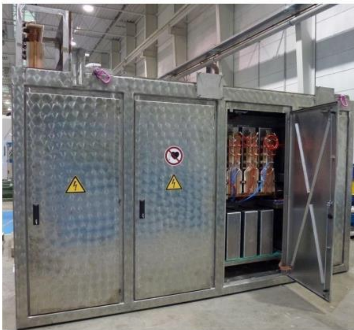
Figur 19 Exempel på ett kondensatorskåp
