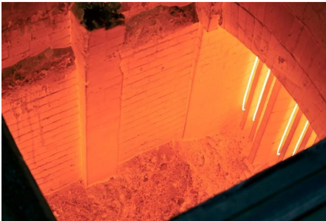
Figur 3 Elektriskt värmd gropugn på Kanthal i Hallstahammar
