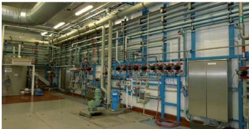
Interiör från ny syraåtervinningsanläggning i Avesta.
