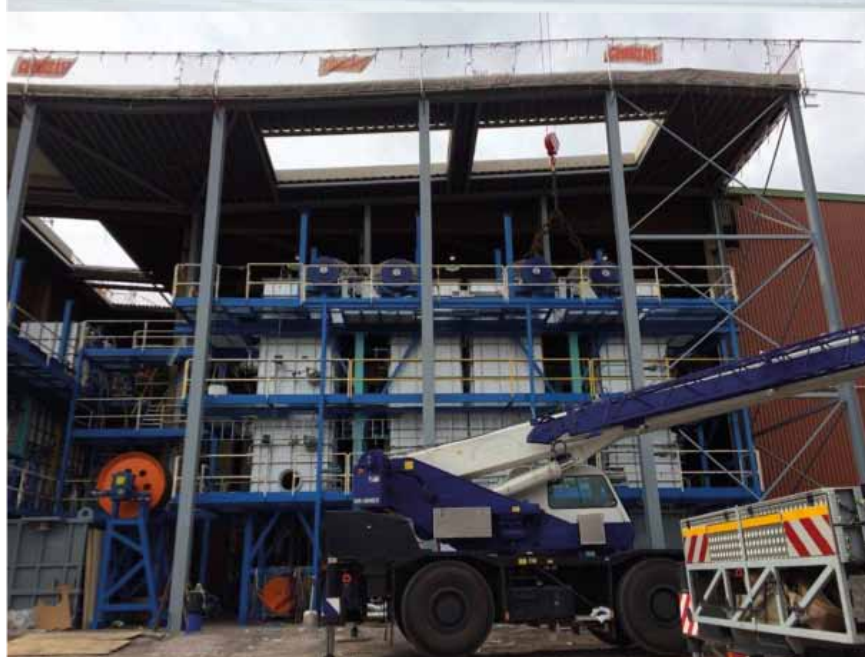
Konvertering till LNG och investeringar i nya ugnar i Ramnäs.
