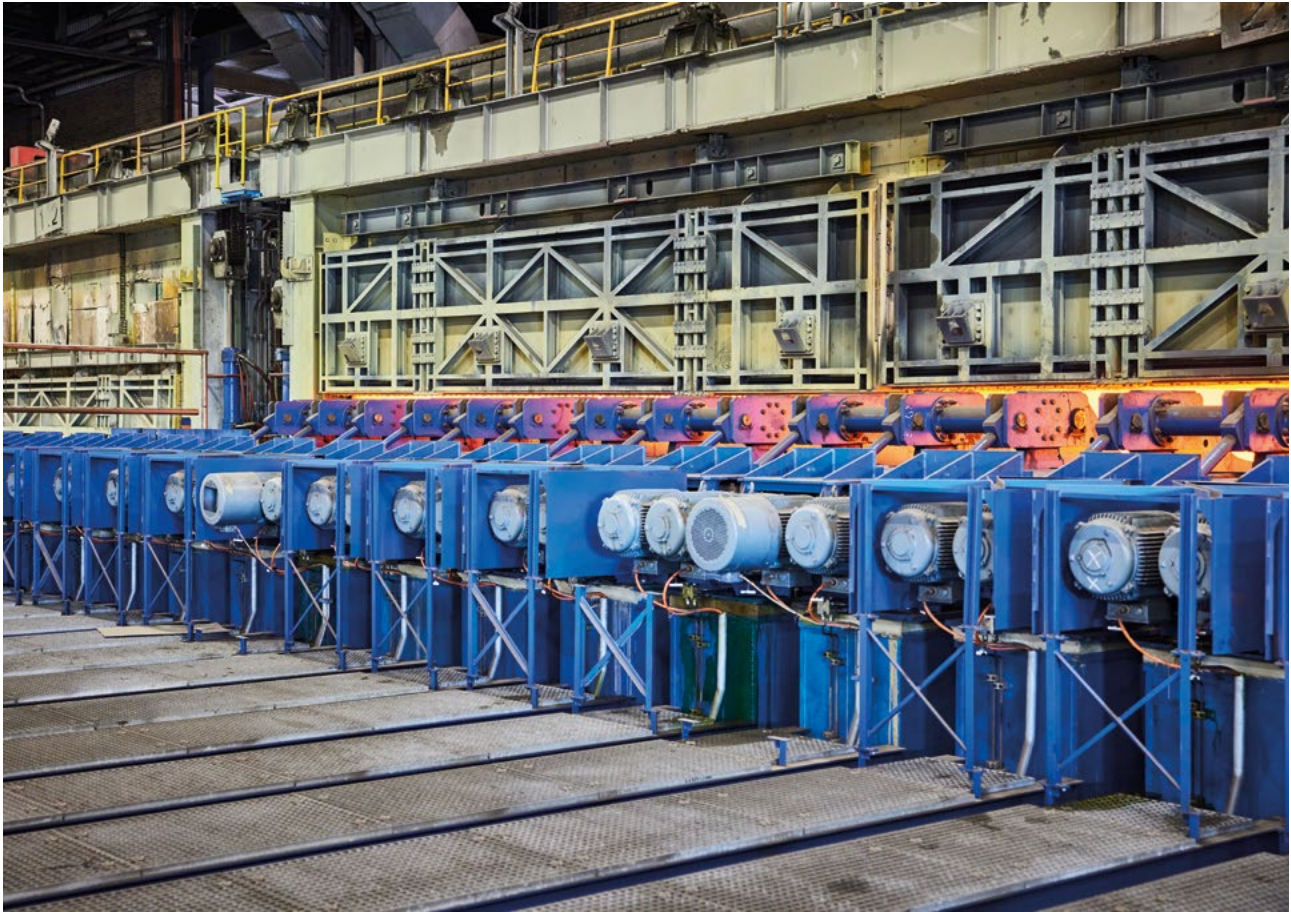
Värmningsugnar vid Outokumpus valsverk i Degerfors. Outokumpu är ett av de tolv medlemsföretagen i teknikområde 51, Energi- och ugnsteknik. Foto: Pia Nordlander.
